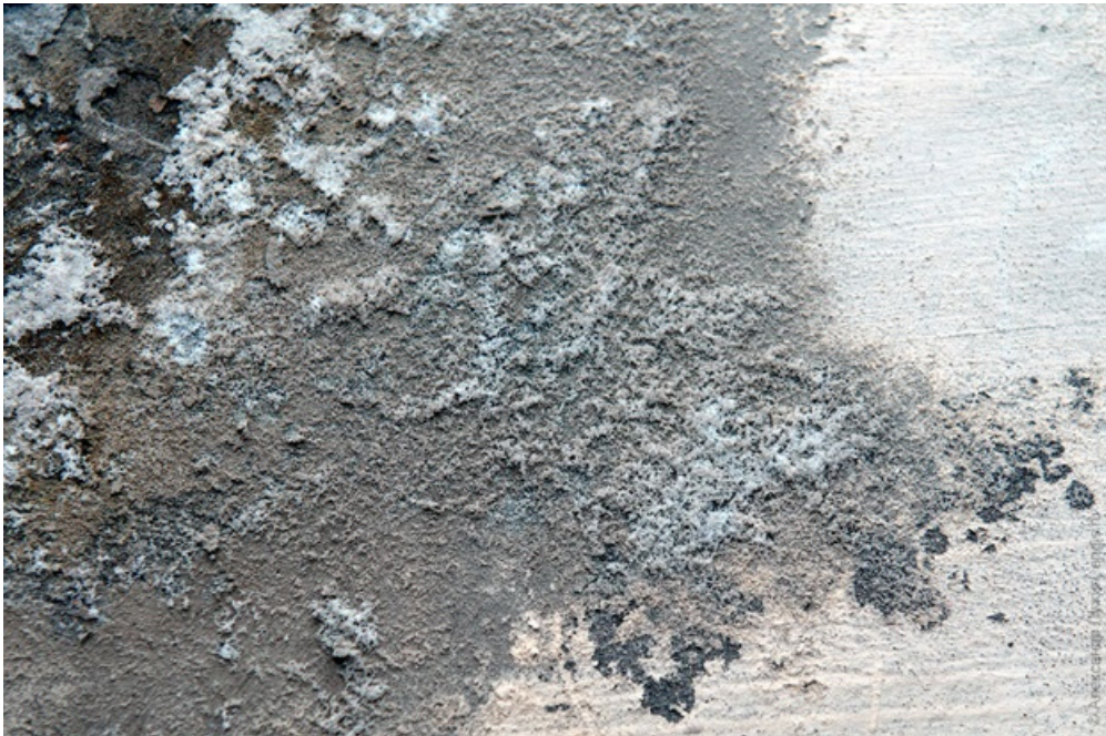
Фото 1. Грибковое поражение поверхности бетона
