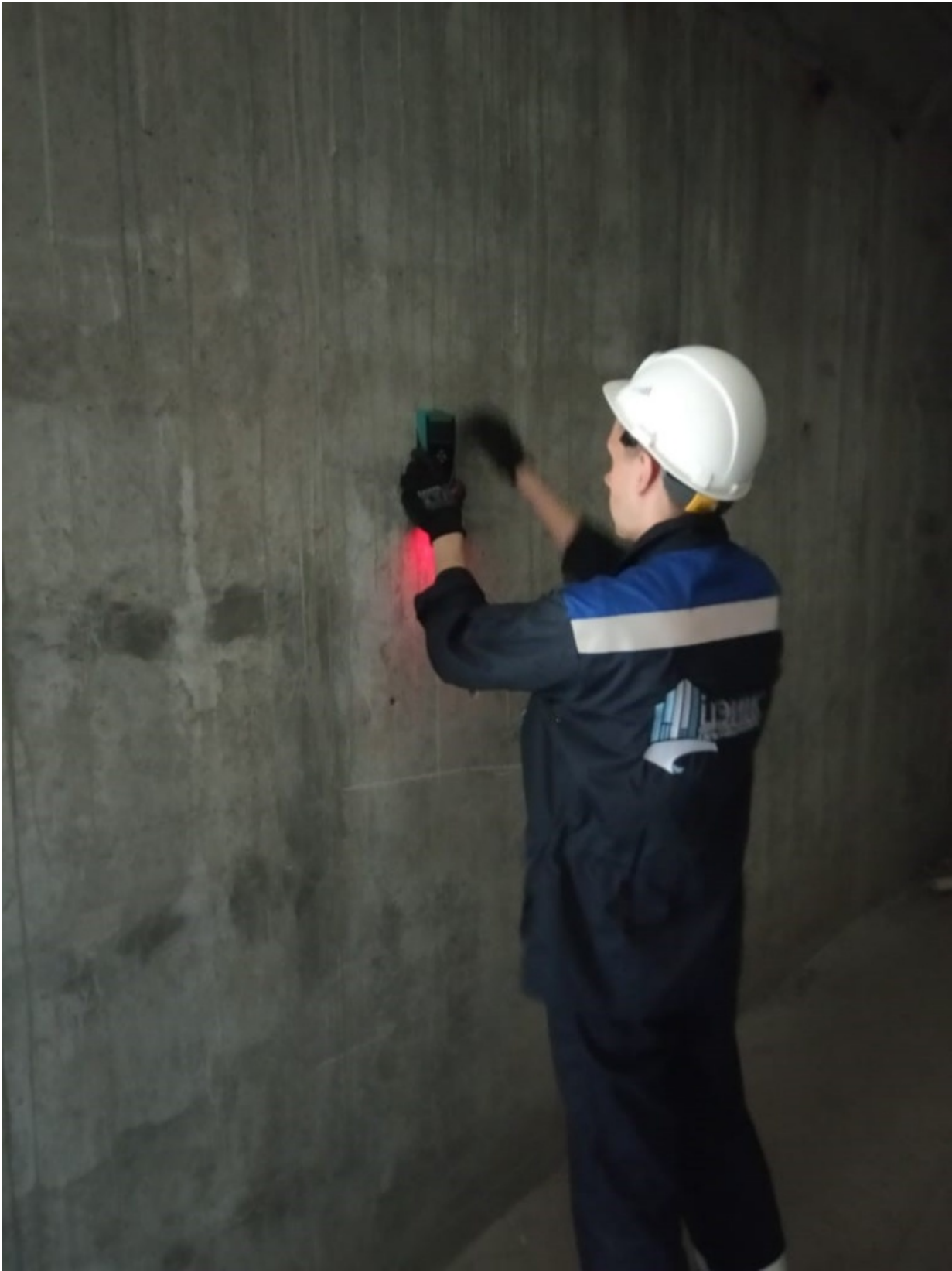
Рис. 3. Проверка соответствия толщины защитного слоя бетона и соответствия шага армирования в ж/б конструкциях
