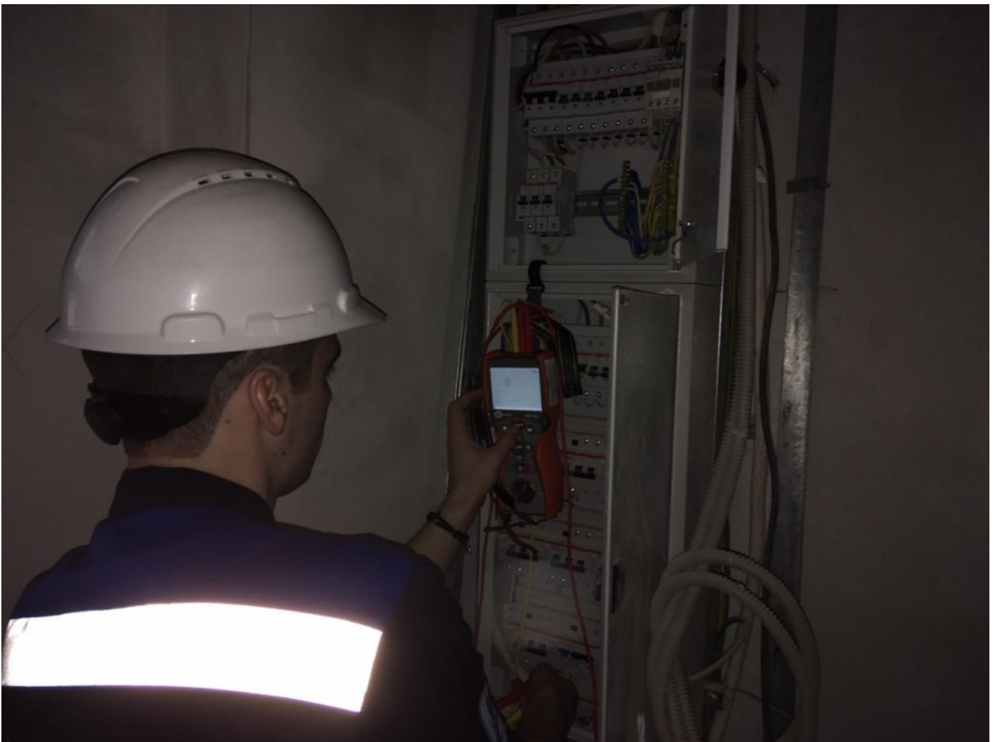
Выполнили оценку соответствия сопротивления изоляции электрических аппаратов, вторичных цепей и
