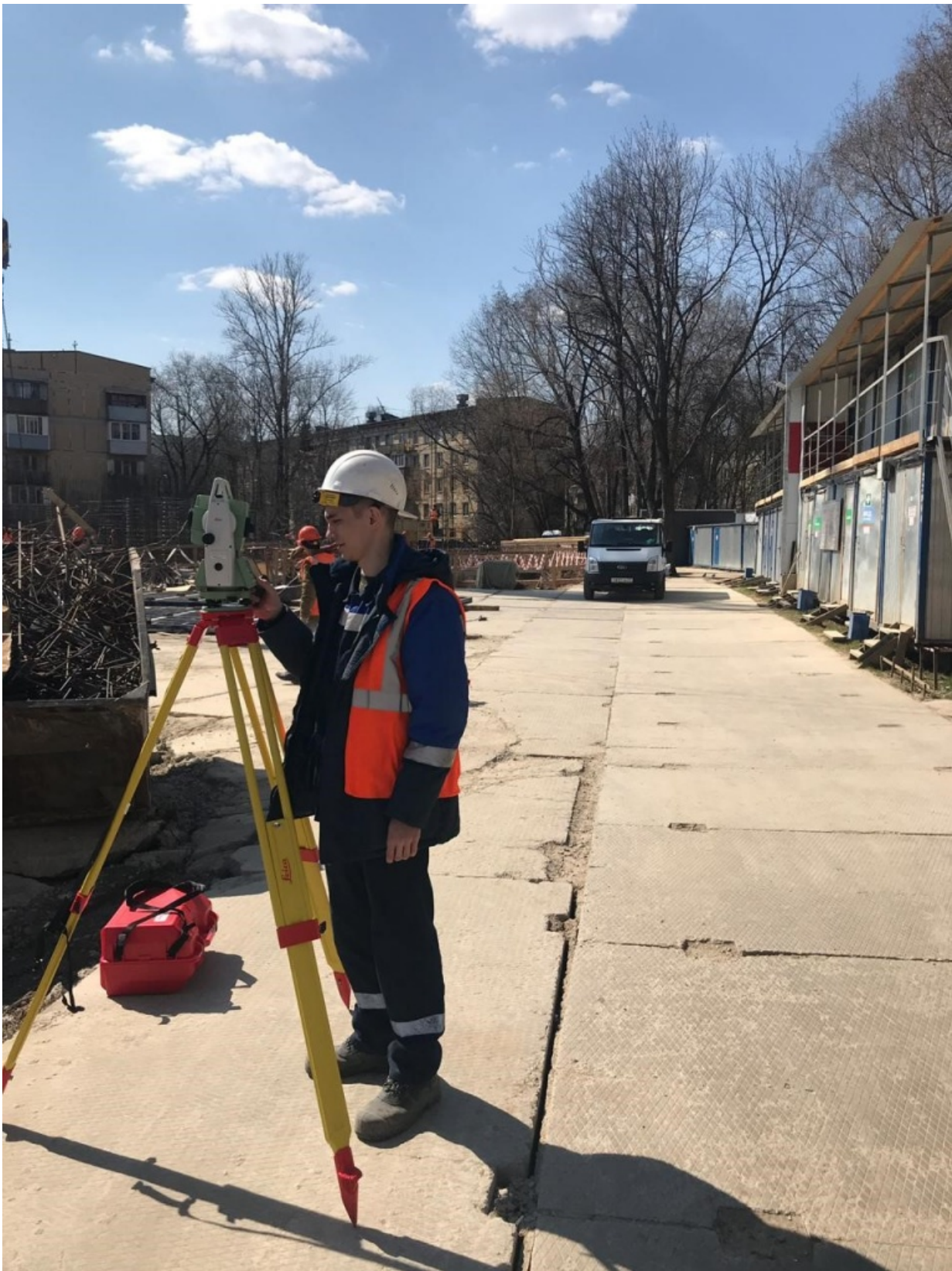
оценка соответствия положения оси линейного сооружения требованиям технических регламентов и проектной документации
